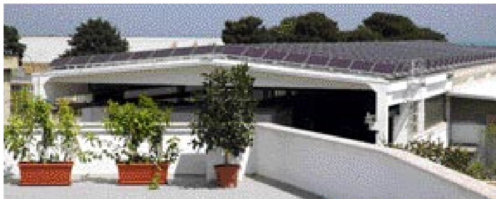
La copertura dell'azienda coi moduli fotovoltaici a film sottile.
